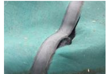
図3 破損事例(シートの裂け)
