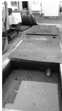
(事例1: 汚泥満杯状態の油水分離槽)
